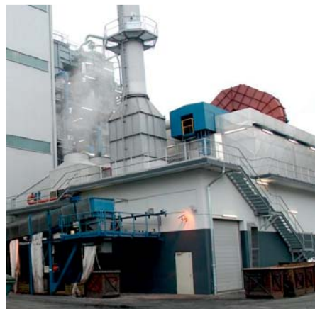
Filteranlage mit Gebläse- haus und Kamin
